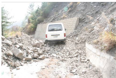
照片 3-1 楠梓仙溪林道 3 月的崩塌
