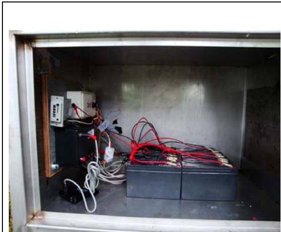
圖 4.3 主機箱內之設備裝置圖
