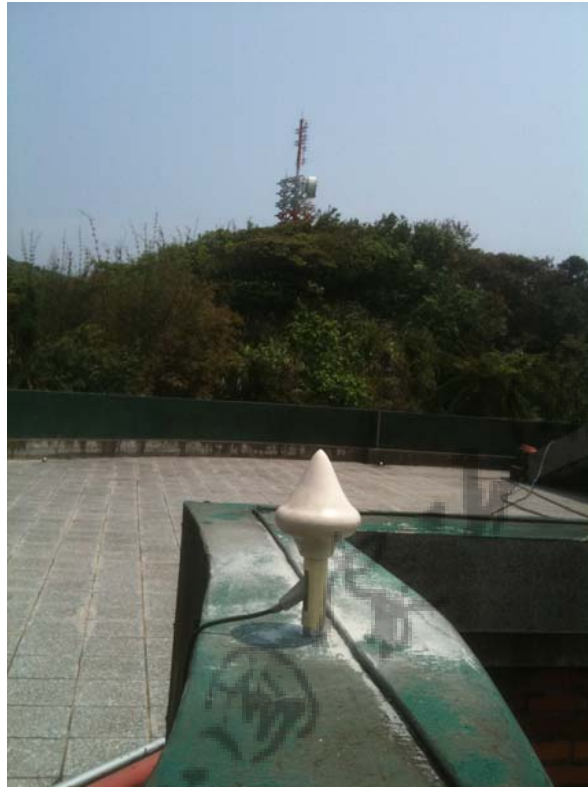
圖 44 湖田國小單頻 GPS 土石流潛勢監測站之室外天線接受器。
