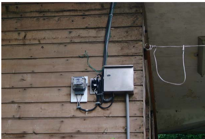
圖九 一個 GPS 觀測站所使用之電力來源裝置。
