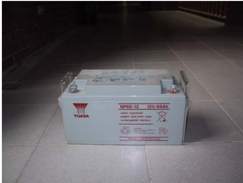
圖十六 一般微震站內維持地震儀器運作之主要電池。
