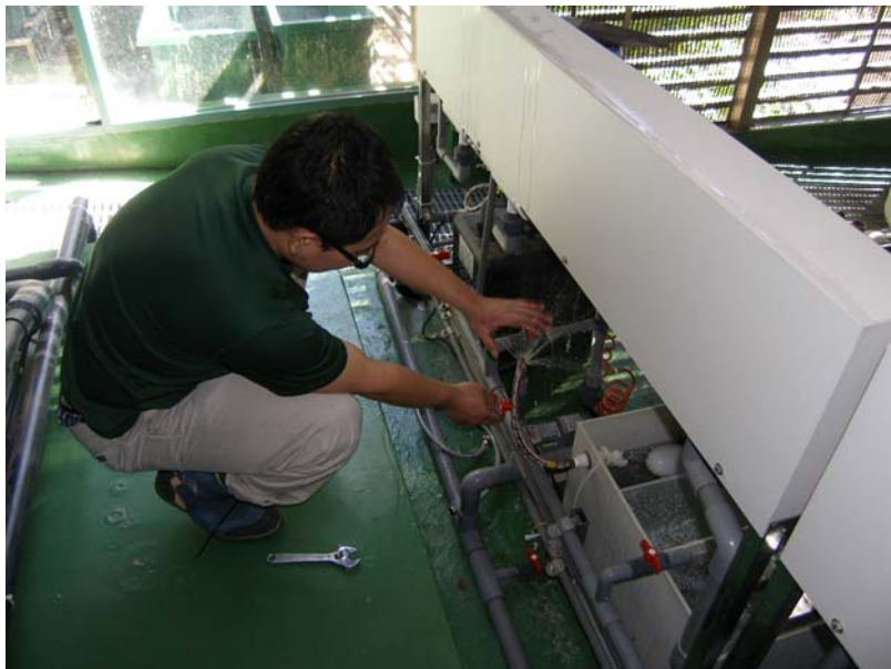
漏水的鐵軟管
