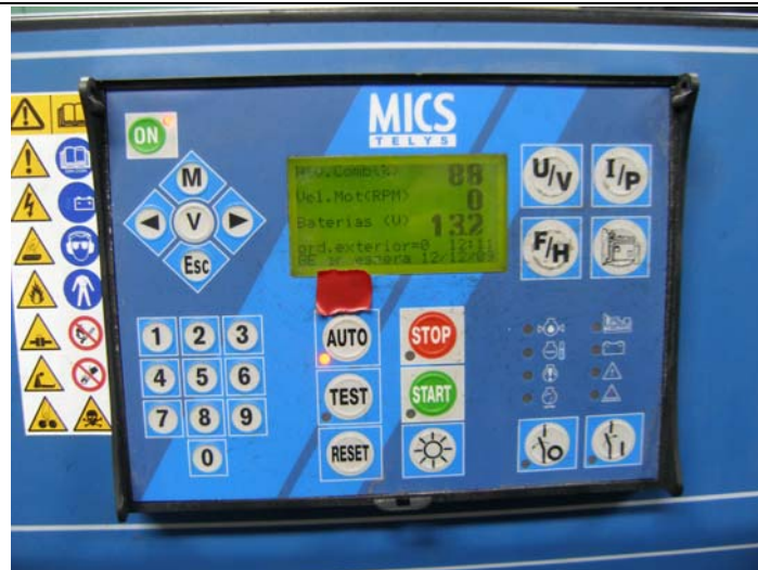
發電機控制表
