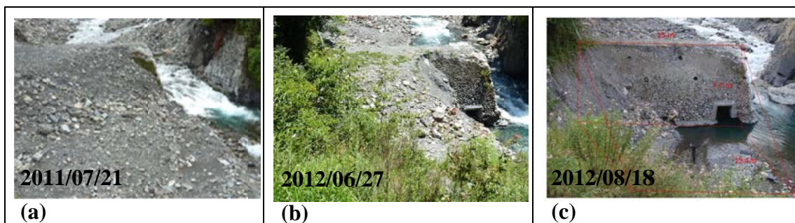
圖 4-1 回填土方變遷 (a) 米雷颱風後 (b) 梅雨、泰利颱風後 (c) 蘇拉颱風後
