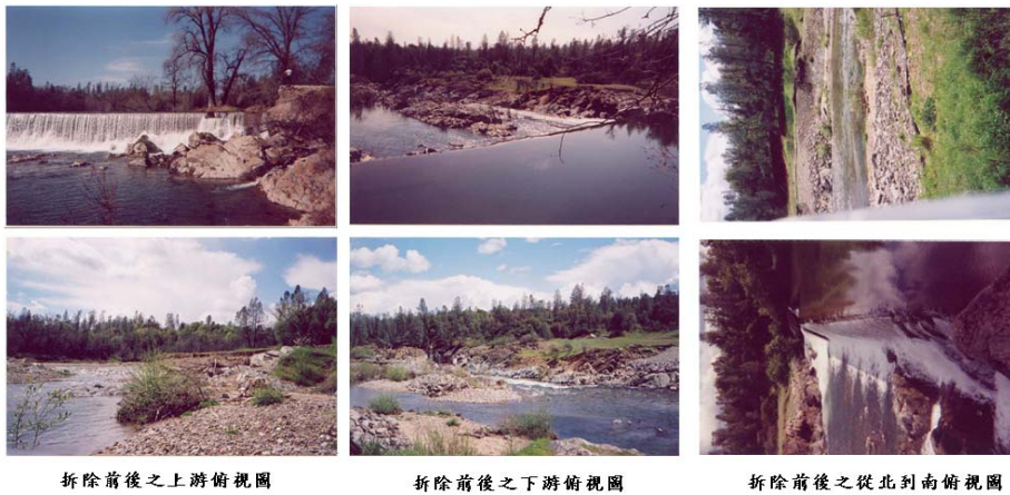
圖 2-5 Saeltzer Dam 分別為拆除前後之從北到南俯視圖(McBain et al., 2006)
