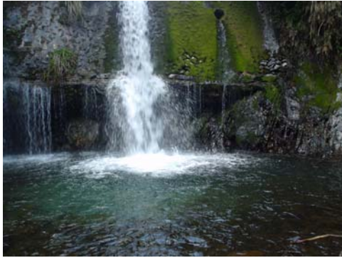
圖 3-22 七家灣溪七號壩下壩基淘蝕
