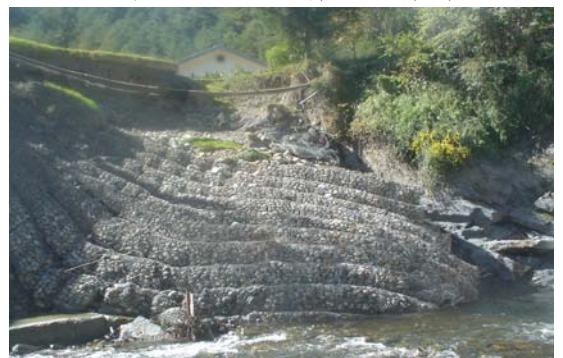
圖 3-61 一號壩下游右岸蛇籠倒塌 35
