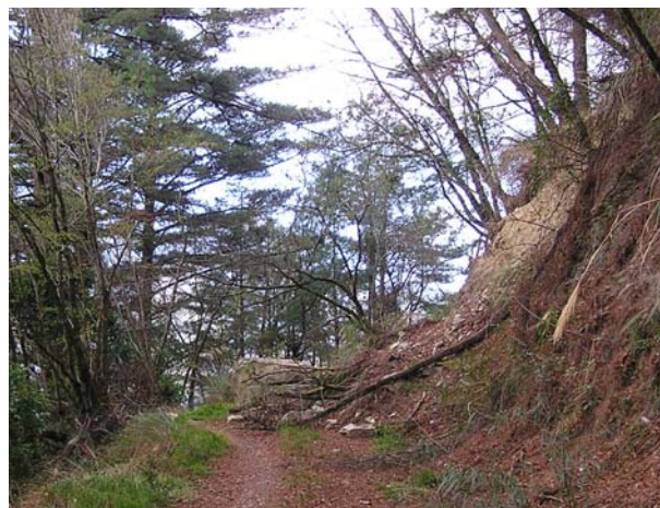
照片2、大鹿林道東線13.5k 道路輕微坍塌 狀況(2009. 3. 1)
