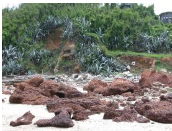
▲ 崖壁上的礮堡受重力而崩塌
