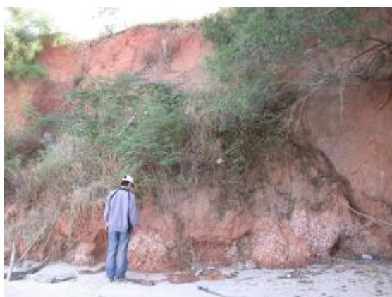
▲ 南山崩塌的崖壁，崩塌處植被繼續生長
