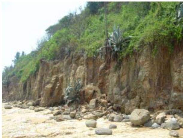
▲正在快速崩塌的玄武岩壁之二
