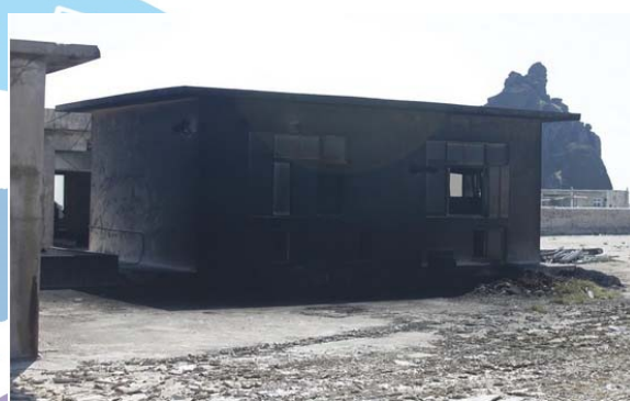
東嶼坪嶼發電站
