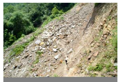
沖毀下方路面上下壁皆崩塌
